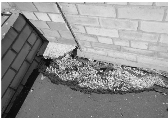
Рис. 3 - Провал асфальтовой отмостки
