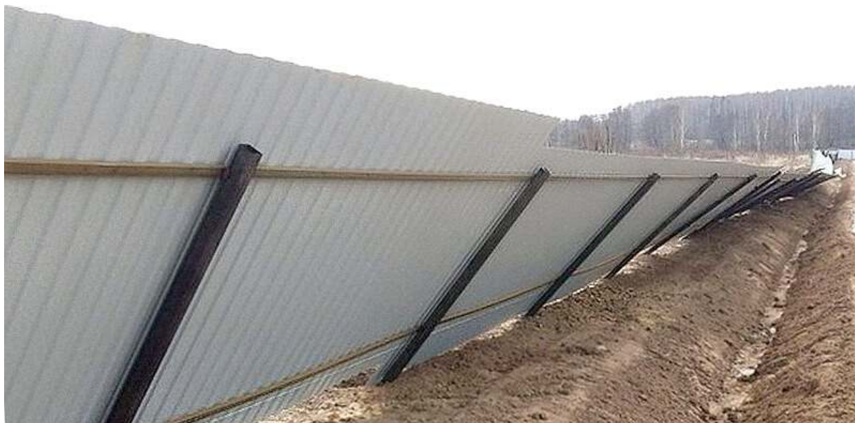
Рис. 1 - Неудачное проектирование и установка забора (разработано автором)
